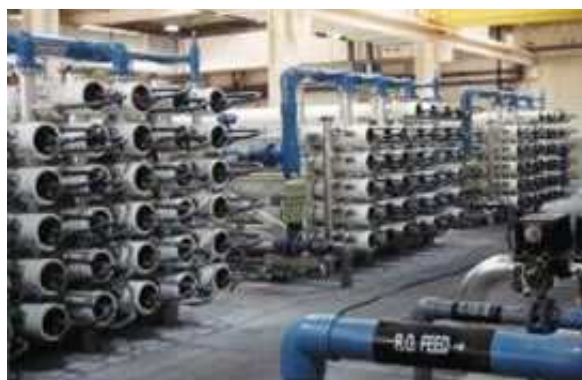
Figura 3.5 – Planta de Nanofiltração (FONTE: DAHER, 2003)
