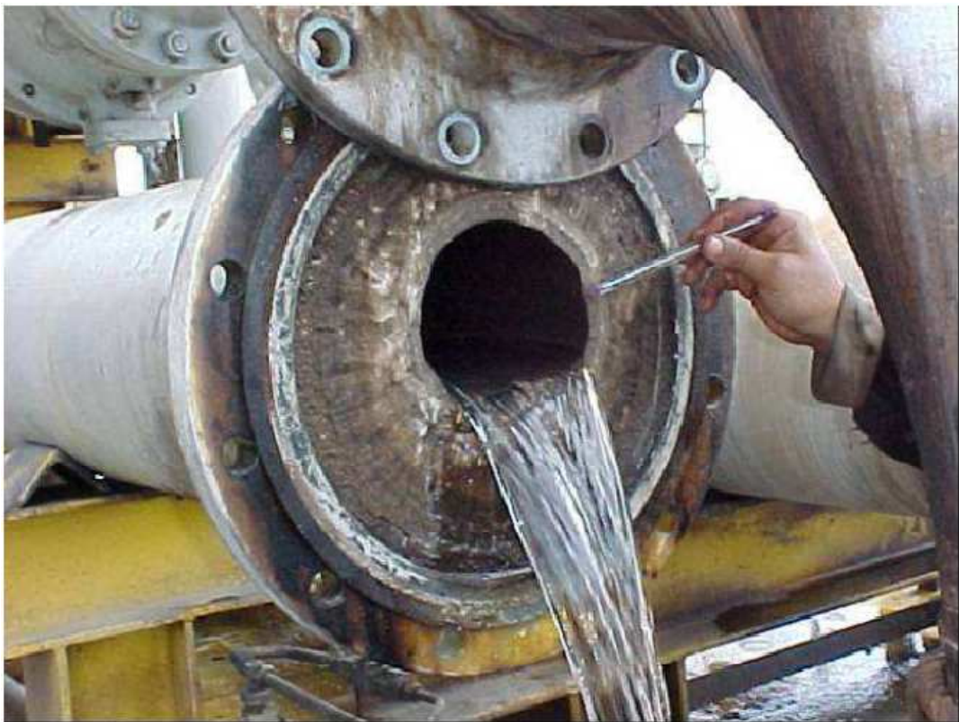
Figura 2.1 – Incrustação em uma tubulação de descarte de água (P-40) (FONTE: GOMES e COSTA, 2009).
