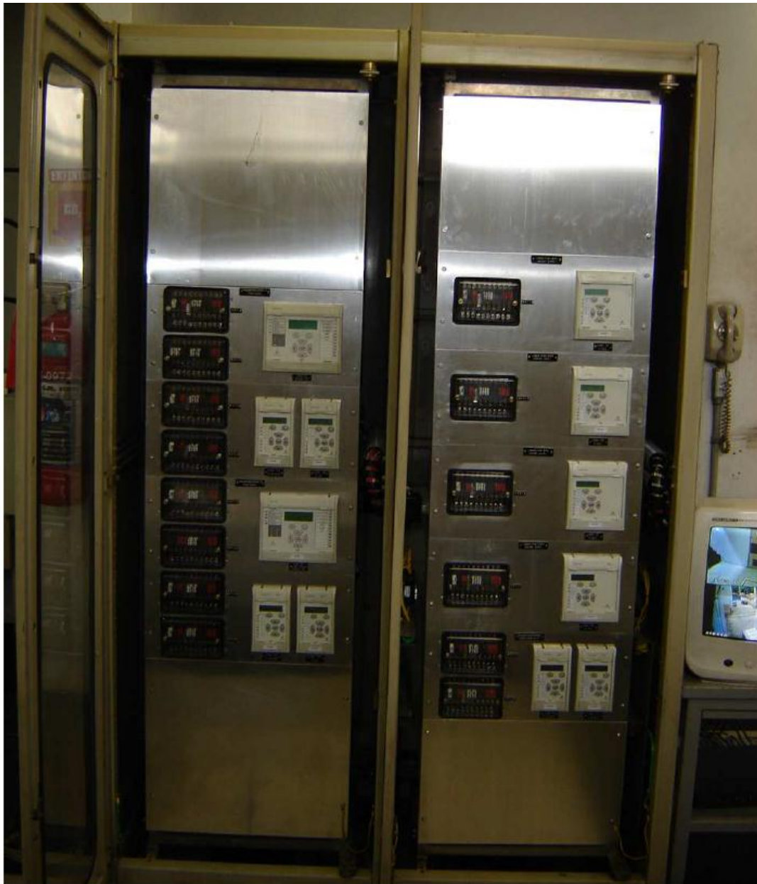
Figura 36. Relés digitais e seus blocos de testes na subestação Botafogo
