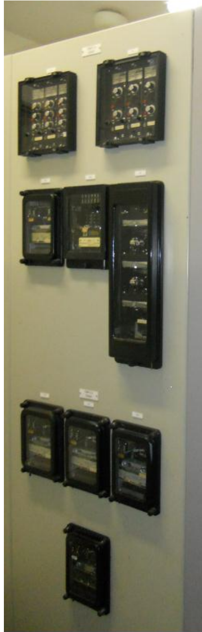
Figura 44. Painel de proteção principal
