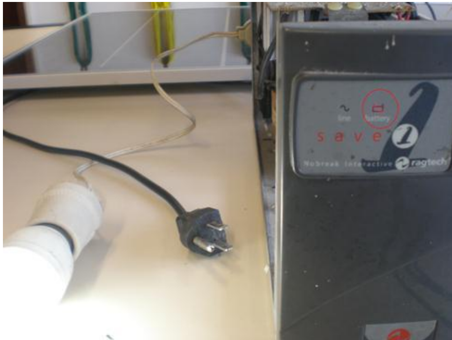
Figura 8.11 - No-break operando sem fornecimento da rede
