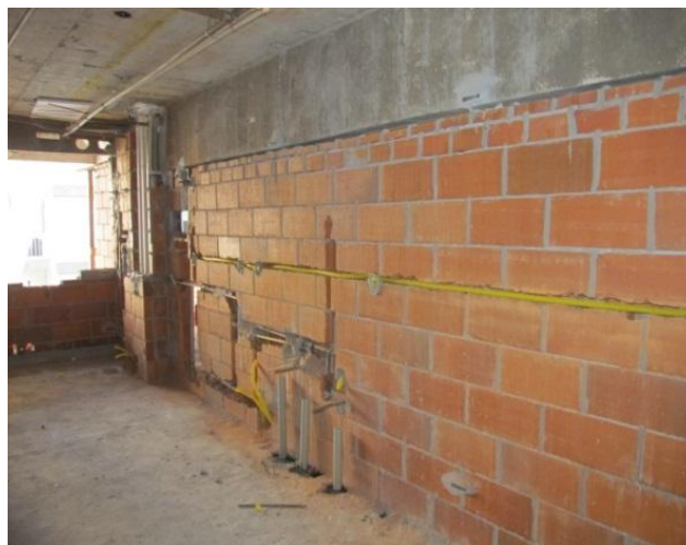
Fig.35 – Exemplo instalação inapropriada
