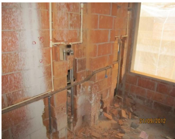
Fig.34 – Exemplo instalação inapropriada
