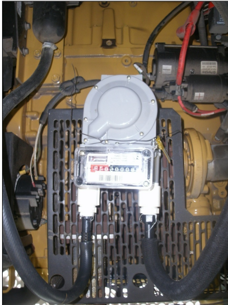
Figura 3.4 Medidor de vazão de GNV e biogás
