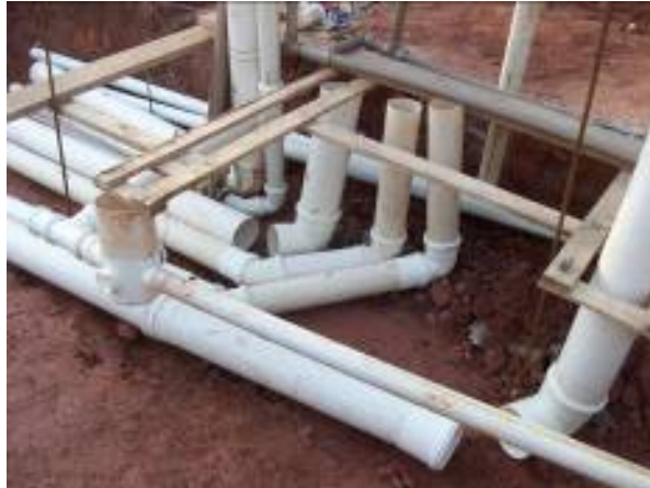
Figuras 54. Kit esgoto (Fonte: Caderno de encargos da construtora, 2011)
