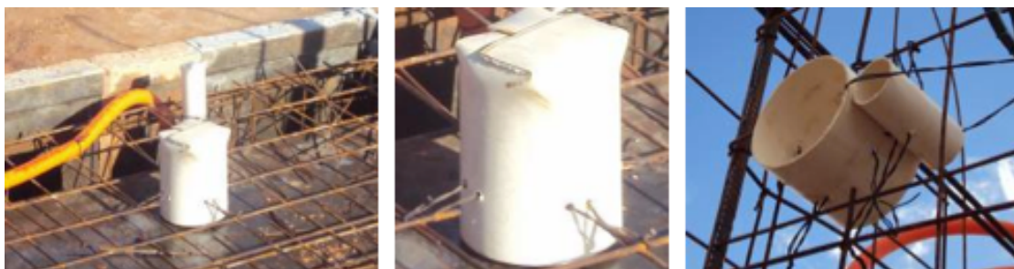
Figuras 55, 56 e 57. Passantes na laje e parede de concreto, respectivamente.
