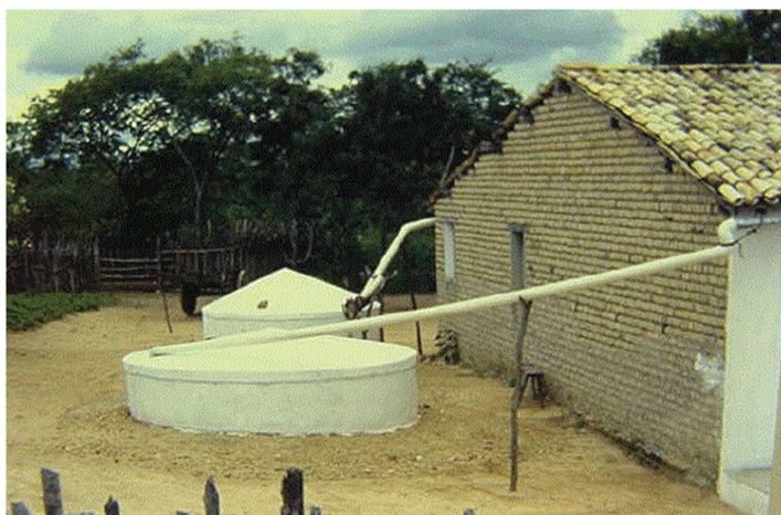
FIGURA 2 – Sistema de Coleta e Armazenagem de água Pluvial.
