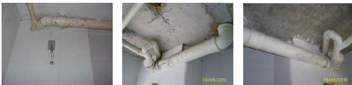
Figura 3: Desconforto visual causado pela ausência de forro falso. Fonte: Gnipper, 2010.
