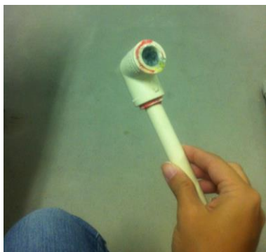
Figura 8: Duto de água quente com argamassa no joelho. Indícios de fraude do sistema. Fonte: Acervo da Autora.
