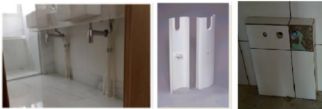
Figura 20: Da esquerda para direita - Instalações aparentes sob bancada. Fonte: Moreira, 2010. Carenagem em PVC. Fonte: Moreira, 2010. Kit revestido em drywall e cerâmica. Fonte: Acervo da autora.
