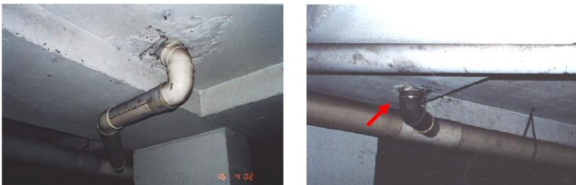
Figura 2: Interferencia do Sistema predial de esgoto com vigas, devido a falta de compatibilização de projeto. Fonte: Gnipper, 2010.
