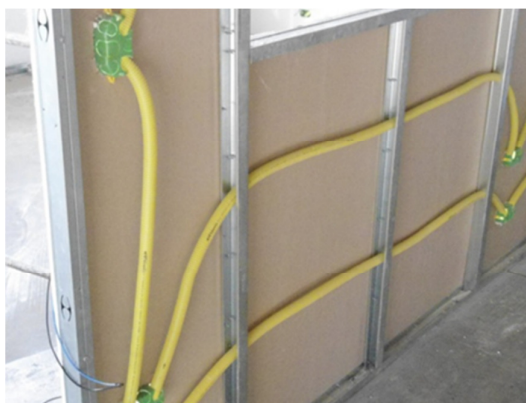
Figura 20 - Instalações elétricas ( www.facilitieservicos.com.br , 2013)
