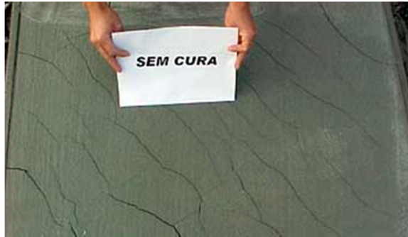
Figura 8 - Fissuras devido à falha de cura (www.basf-cc.com.br, 2014)
