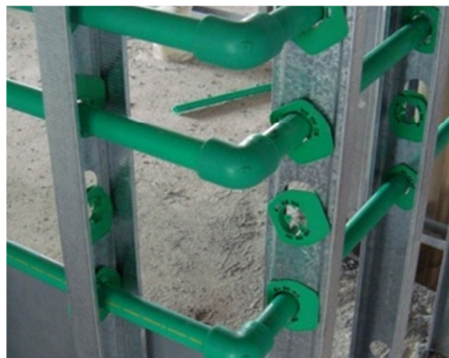
Figura 21 - Instalações Hidráulicas ( www.facilitieservicos.com.br , 2013)
