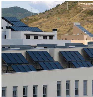
Fuente: Libro Urbanismo Bioclimático, pagina 153, de Ester Higuera Ilustración 91: Instalación de energía solar térmica
