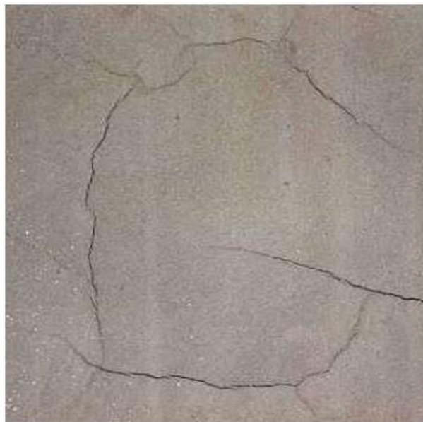
Figura 11- Fissuras devido à alta retração (THOMAZ,2014)
