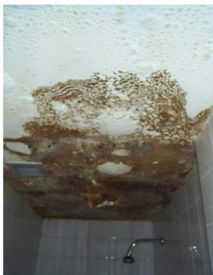
Figura 9– Infiltração por vazamento em conexão (OLIVEIRA,2013)
