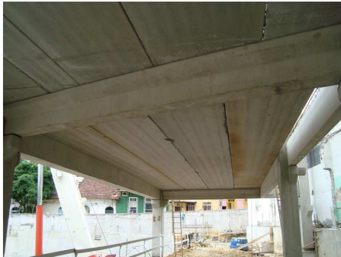
Figura 45: Vão de difícil acesso para concretagem in loco a direita
