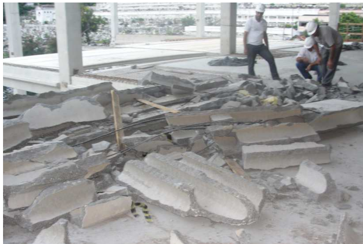
Figura 46: Desabamento de laje alveolar
