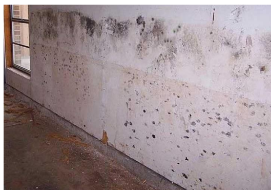
Figura 31 – Parede com infiltração e umidade - Fonte: http://www.forumdaconstrucao.com.br/
