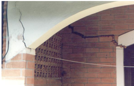
Figura 22 – Trinca causada por recalque de fundação - Fonte: http://www.ebanataw.com.br/
