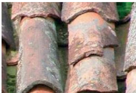
Figura 82 – Telhas quebradas - Fonte: http://construironline.dashofer.pt/
