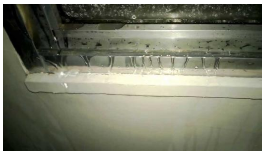
Figura 51 – Infiltração em janela - Fonte: https://i.ytimg.com/
