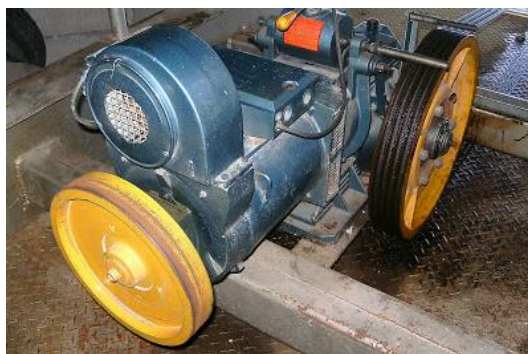
Figura 80 – Ausência de proteção em polias - Fonte: http://eletronordeste.blogspot.com.br/
