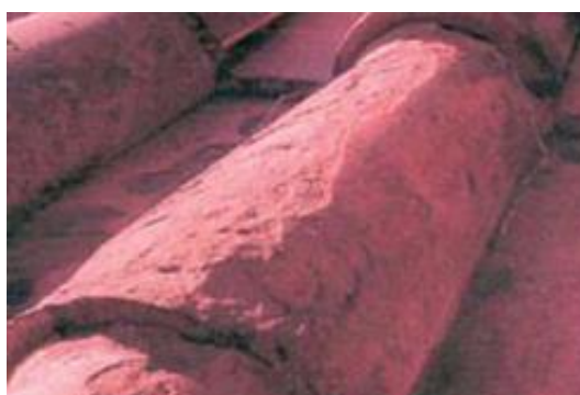
Figura 83 – Telhas deterioradas - Fonte: http://construironline.dashofer.pt/
