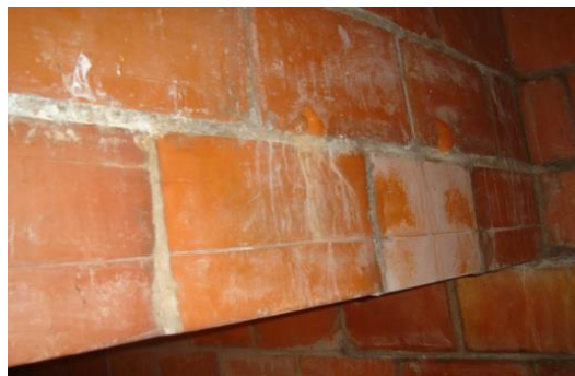
Figura 21 – Eflorescência em alvenaria estrutural - Fonte: CORRÊA (2010)
