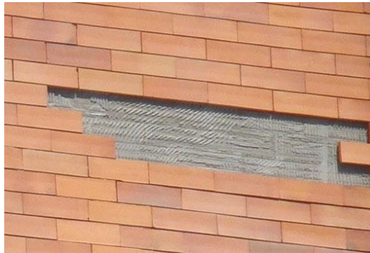
Figura 33 – Descolamento de revestimento - Fonte: http://www.drfaztudo.com.br/
