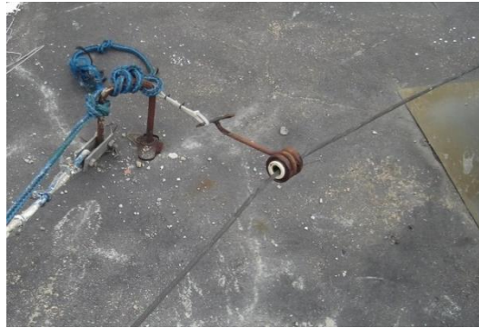
Figura 87 – Isolador solto e oxidado - Fonte: http://paulobahiasindico.blogspot.com.br/
