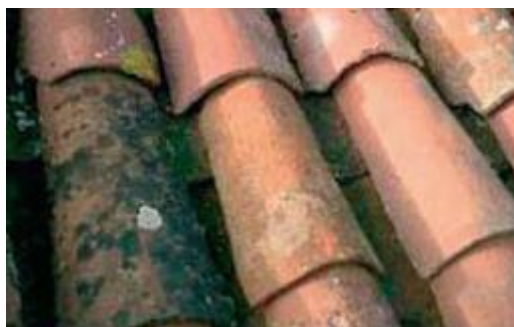
Figura 85 – Musgos em telhas - Fonte: http://construironline.dashofer.pt/
