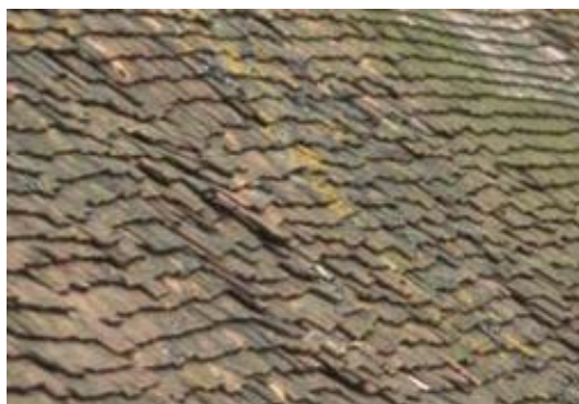
Figura 84 – Deslocamento e desalinhamento de telhas - Fonte: http://construironline.dashofer.pt/
