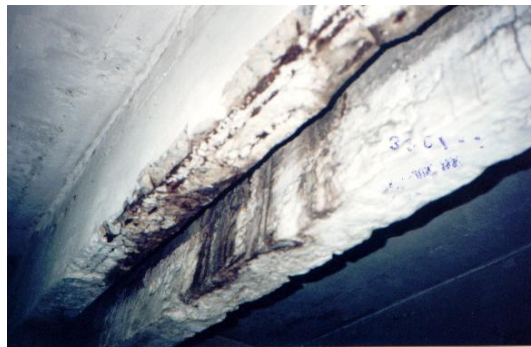
Figura 56 – Infiltração em junta de dilatação - Fonte: http://www.ebah.com.br/
