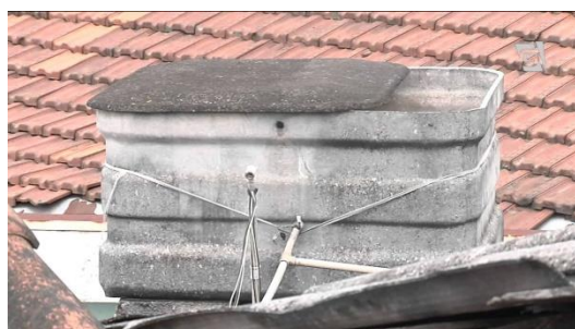
Figura 62 – Tapa de caixa d'água inadequada - Fonte: http://cyberspaceandtime.com/
