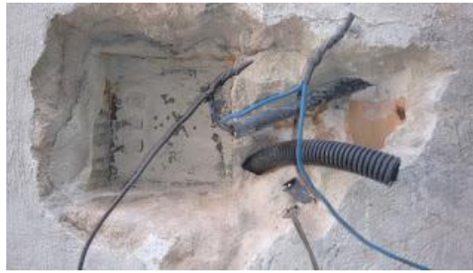
Figura 67 – Caixa de passagem e eletroduto inadequado - Fonte: http://residencismart.blogspot.com.br/
