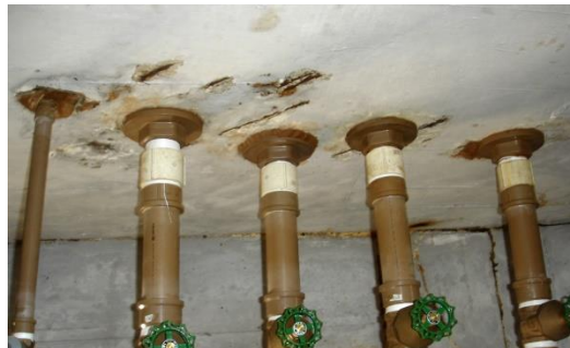
Figura 57 – Infiltração sob caixa d'água - Fonte: http://www.imperflexdobrasil.com.br/
