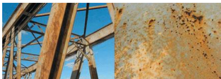
Figura 13 – Corrosão generalizada - Fonte: BRINCK et al. (2005).
