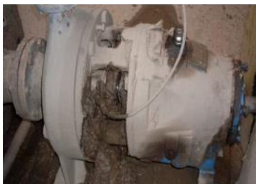
Figura 81 – Bomba com gaxeta desgastada - Fonte: https://lcsimei.files.wordpress.com/
