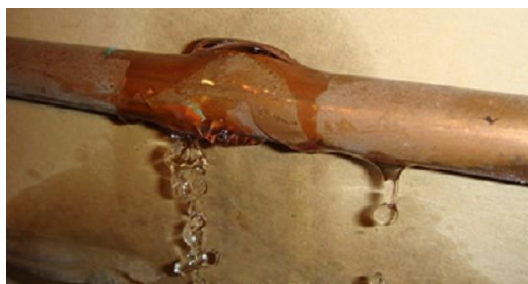
Figura 59 – Vazamento em tubulação de água fria - Fonte: http://www.tech-connect.info/
