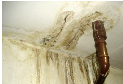
Figura 54 – Infiltração ao lado de tubo que drena o ralo - Fonte: http://www.imperflexdobrasil.com.br/
