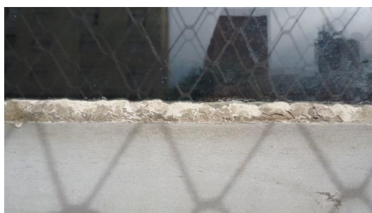
Figura 50 – Massa de vidraceiro deteriorada - Fonte: http://static.habitissimo.com.br/
