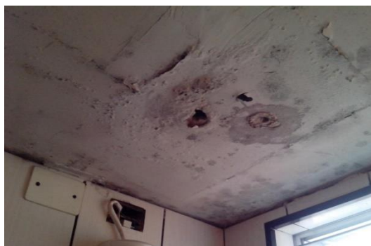
Figura 52 – Infiltração no teto do banheiro - Fonte: http://static.habitissimo.com.br/
