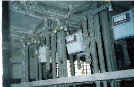
Figura 72 – Tubulação de gás deteriorada - Fonte:
