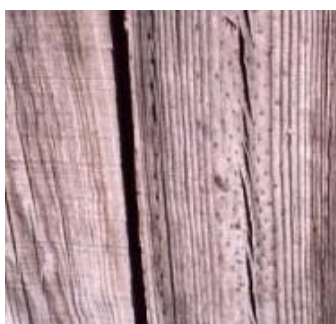
Figura 17 – Madeira deteriorada por intemperismo - Fonte: http://construironline.dashofer.pt/
