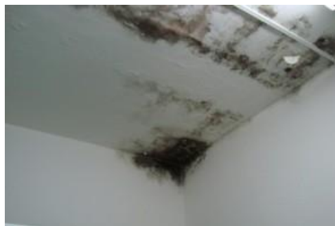
Figura 45 – Manchas de bolor no teto - Fonte: http://removermanchas.com/
