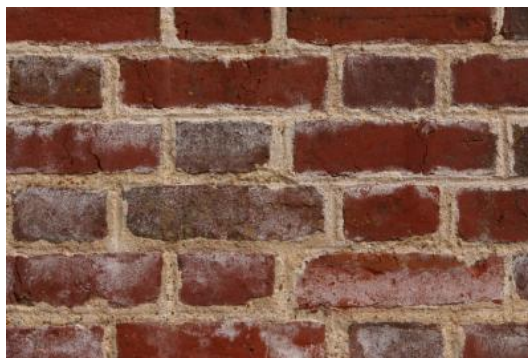
Figura 32 – Eflorescência em alvenaria - Fonte: http://photos.demandstudios.com/
