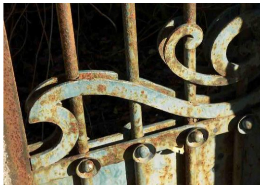
Figura 47 – Corrosão em portão de ferro - Fonte: http://portoesportao.com/
