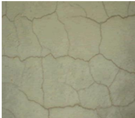
Figura 34 – Fissuras em revestimento - Fonte: http://www.healtintas.com.br/
