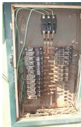
Figura 69 – Barramento sem proteção - Fonte: http://eletricagimeness.blogspot.com.br/
