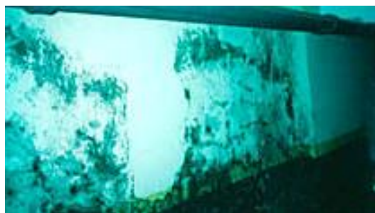
Figura 55 – Infiltração em subsolo - Fonte: http://www.forumdaconstrucao.com.br/
