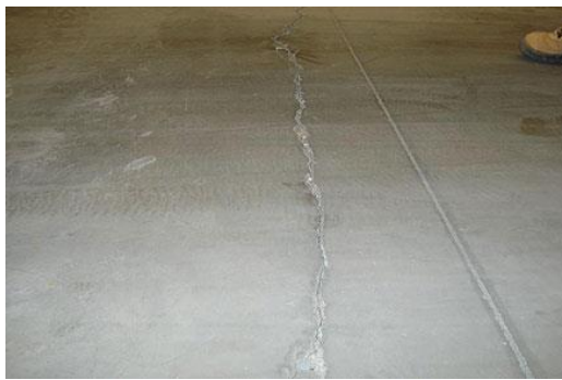
Figura 39 – Fissura em piso de concreto - Fonte: http://techne.pini.com.br/
