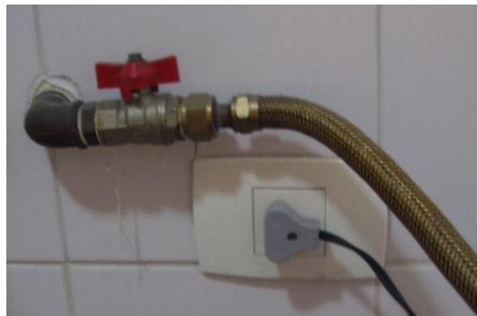
Figura 73 – Instalação elétrica próxima à tubulação de gás - Fonte:
