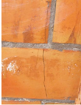
Figura 20 – Fissura vertical em alvenaria estrutural - Fonte: CORRÊA (2010)
