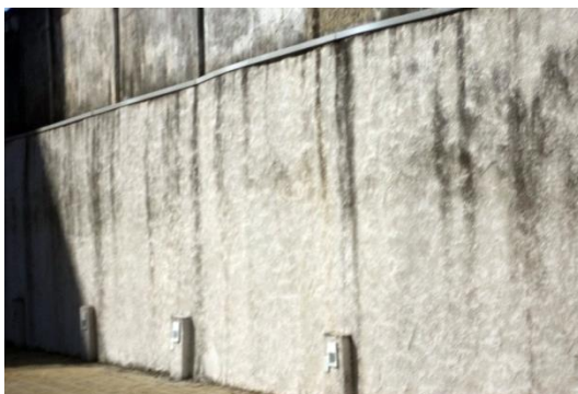
Figura 36 – Manchas em revestimento de parede causadas por infiltração de água da chuva - Fonte: http://static.habitissimo.com.br/
