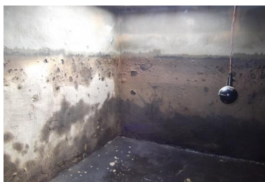
Figura 61 – Caixa d'água com estrutura deteriorada - Fonte: http://www.desentupidorahidromaster.com.br/
