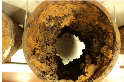
Figura 64 – Tubulação encrustada- Fonte: http://www.desentupidora.srv.br/
