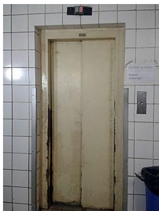
Figura 75 – Porta de elevador danificada - Fonte: http://g1.globo.com/
