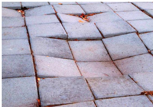
Figura 40 – Desníveis em pavimento de lajotas - Fonte: http://www.materiaincognita.com.br/
