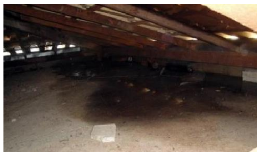
Figura 58 – Infiltração em telhado - Fonte: http://static.habitissimo.com.br
