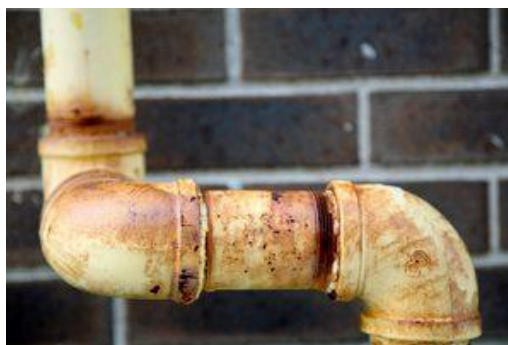
Figura 60 – Deterioração tubulação de PVC - Fonte: http://www.ehow.com.br
