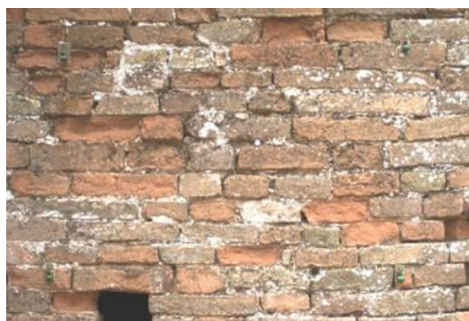
Figura 30 – Deterioração de alvenaria - Fonte: http://www.umbertoalesi.it/
