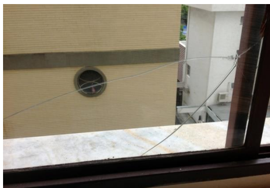
Figura 48 – Trinca em vidro de janela - Fonte: http://static.habitissimo.com.br/
