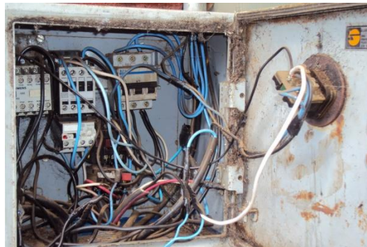
Figura 68 – Quadro de luz com instalações inadequadas - Fonte: http://eletricaesusduvidas.blogspot.com.br/
