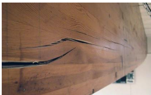
Figura 19 – Fendas na madeira - Fonte: http://estruturasdemadeira.blogspot.com.br/
