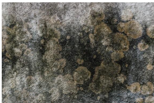
Figura 38 – Bolor em revestimento de parede em decorrência de umidade - Fonte: https://s3-eu-west-1.amazonaws.com/
