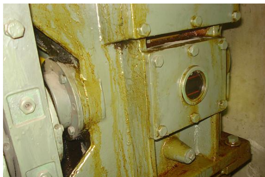
Figura 79 – Vazamento de óleo da máquina - Fonte: http://elevatore.wix.com/
