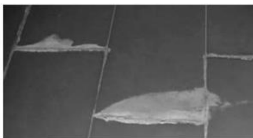
Figura 43 – Eflorescência em piso cerâmico - Fonte: http://construironline.dashofer.pt/
