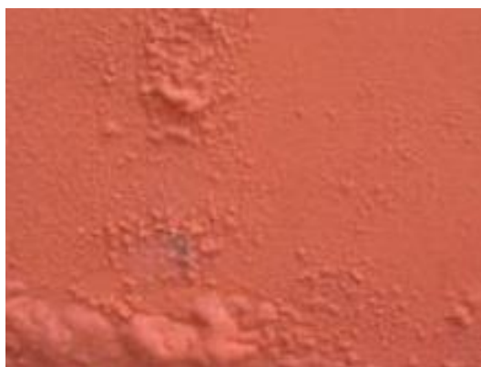
Figura 35 – Vesículas em pintura - Fonte: http://www.copical.com.br/
