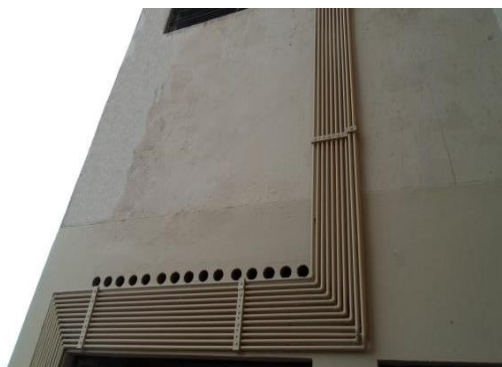
Figura 74 – Tubulação de gás aparente fora da cor padrão - Fonte: http://www.solucoesindustriais.com.br/
