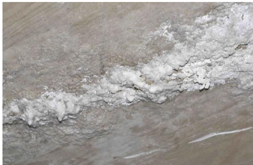
Figura 44 – Eflorescência em teto argamassado - Fonte: http://www.ecivilnet.com/
