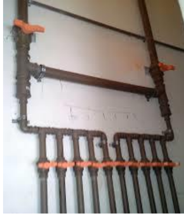
Figura 63 – Barriletes sem pintura e sem identificação - Fonte: http://www.laplan.com.br
