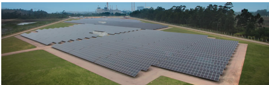
Figura 2.2: Usina fotovoltaica Cidade Azul, em Santa Catarina. Fonte: www.tractebelenergia.com.br .
