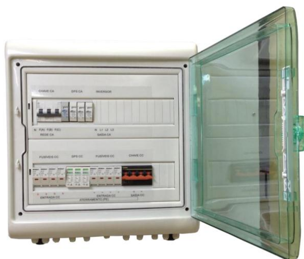
Figura 24 - Caixa de conexão
