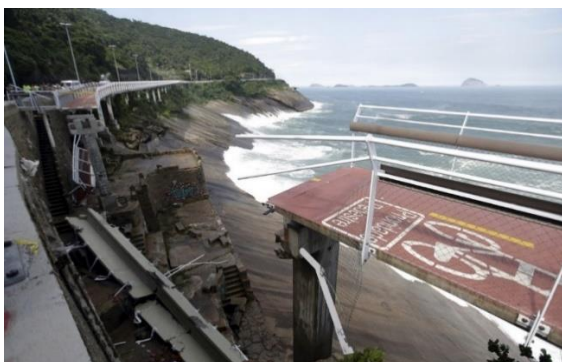
Figura 16: Trecho da ciclovia que desabou. Fonte: O Globo (2016)
