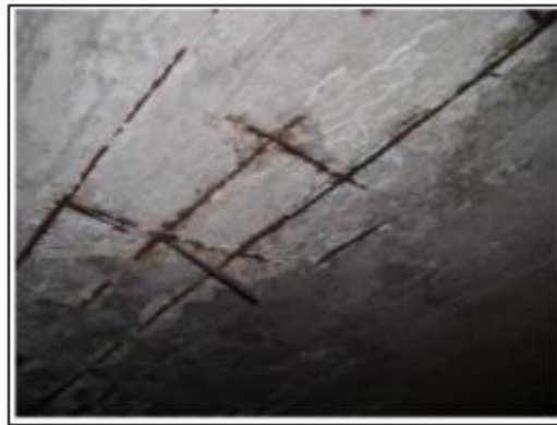
Figura 11: Corrosão nas armaduras de uma laje. Fonte: SILVA (2011)
