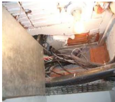
Figura 27: Rede elétrica suscetível à entrada de água. Fonte: RODRIGUES (2013).
