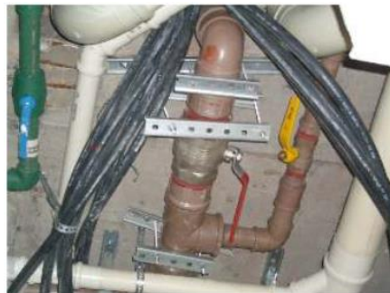
Figura 26: Interferência entre redes elétrica e hidráulica. Fonte: RODRIGUES (2013).
