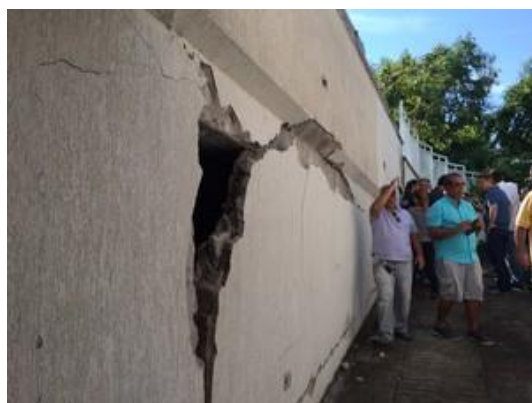
Figura 17: Rachadura em fachada na Vila do Pan. Fonte: COELHO, 2013
