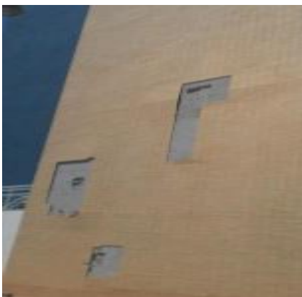
Figura 31: Fachada nordeste apresentando descolamento de placas cerâmicas.
