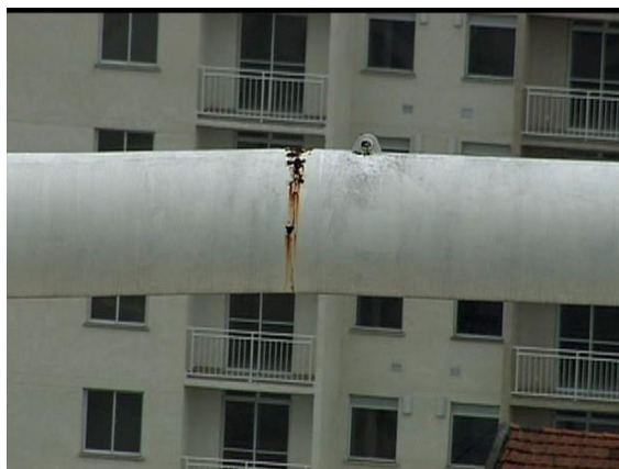
Figura 15: Detalhe da estrutura da cobertura com ferrugem. Fonte: MARINHO, 2013
