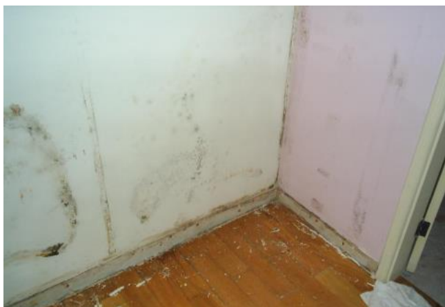
Figura 28: Infiltrações decorrentes de falhas na impermeabilização. Fonte: OLIVEIRA (2013)
