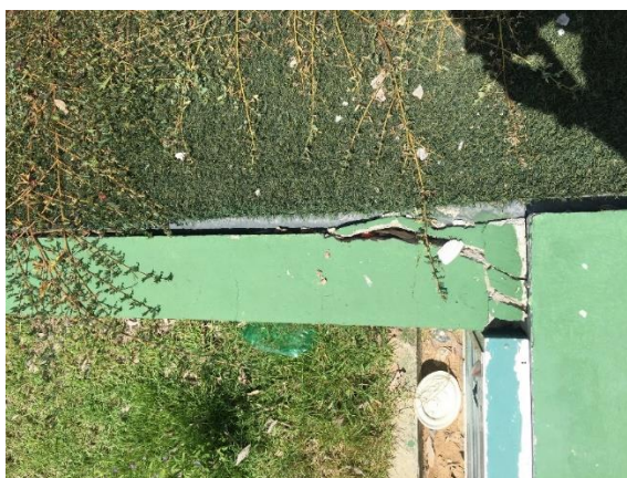
Figura 36: Rachaduras na laje de pedana. Fonte: O autor
