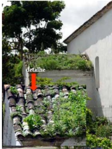
Figura 29: Acúmulo de vegetação devido à falta de manutenção. Fonte: CECI (2014).
