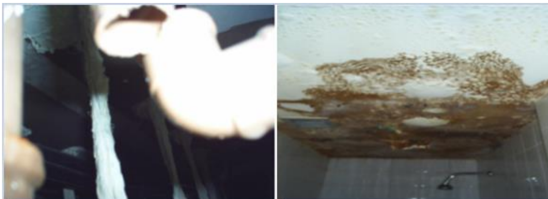
Figura 24: Tubo desconectado pela pressurização do sistema e infiltração no teto
